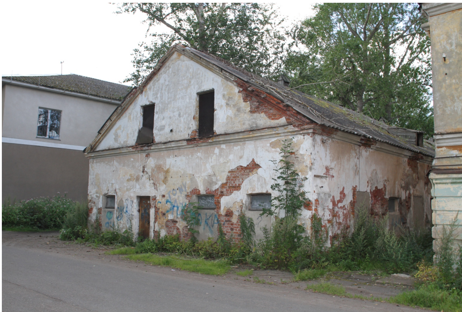
Ил. 16 «Жилой дом -бывший дом Г.Е.Ильинского, XVIII-XIX вв.», входящий в состав ансамбля «Комплекс жилых и хозяйственных зданий, XVIII-XIX вв.». Ленинградская обл., Волховский район, г. Новая Ладога, наб. Ладожской Флотилии, д.22. Хозяйственное здание, восточный фасад. Фото: 15.08.2017.
