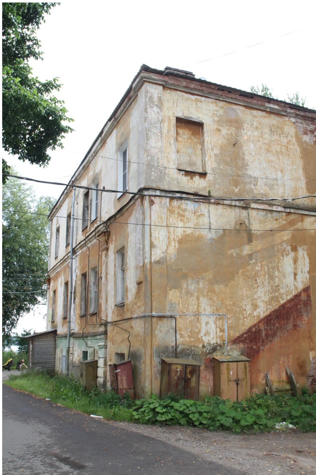
Ил. 9 «Жилой дом -бывший дом Г.Е.Ильинского, XVIII-XIX вв.», входящий в состав ансамбля «Комплекс жилых и хозяйственных зданий, XVIII-XIX вв.». Ленинградская обл., Волховский район, г. Новая Ладога, наб. Ладожской Флотилии, д.22. Жилой дом. Фрагмент дворового фасада, вид с северо-запада. Фото: 15.08.2017.
