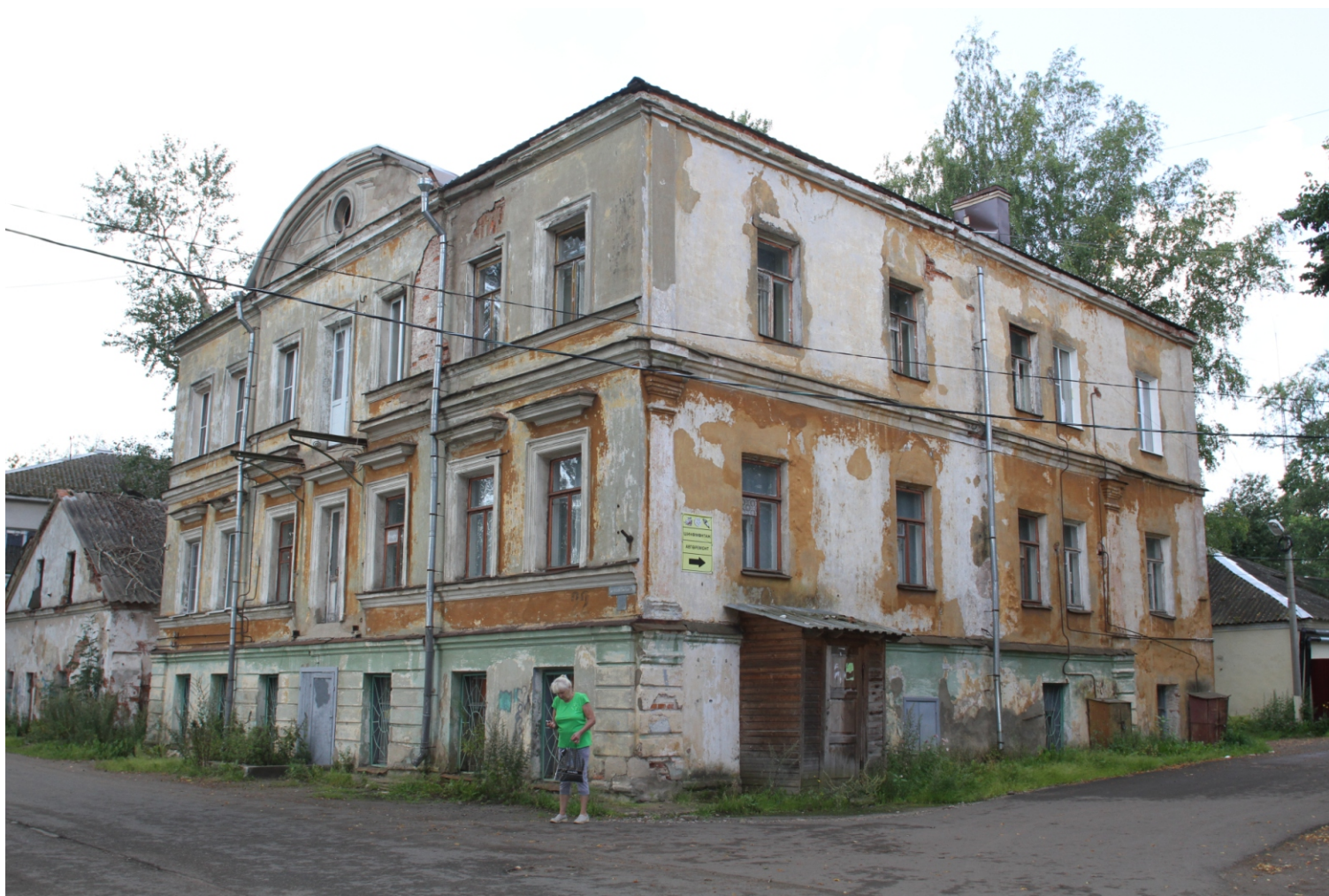
Ил. 5 «Жилой дом -бывший дом Г.Е.Ильинского, XVIII-XIX вв.», входящий в состав ансамбля «Комплекс жилых и хозяйственных зданий, XVIII-XIX вв.». Ленинградская обл., Волховский район, г. Новая Ладога, наб. Ладожской Флотилии, д.22. Жилой дом. Вид на фасады с северо-востока. Фото: 15.08.2017.
