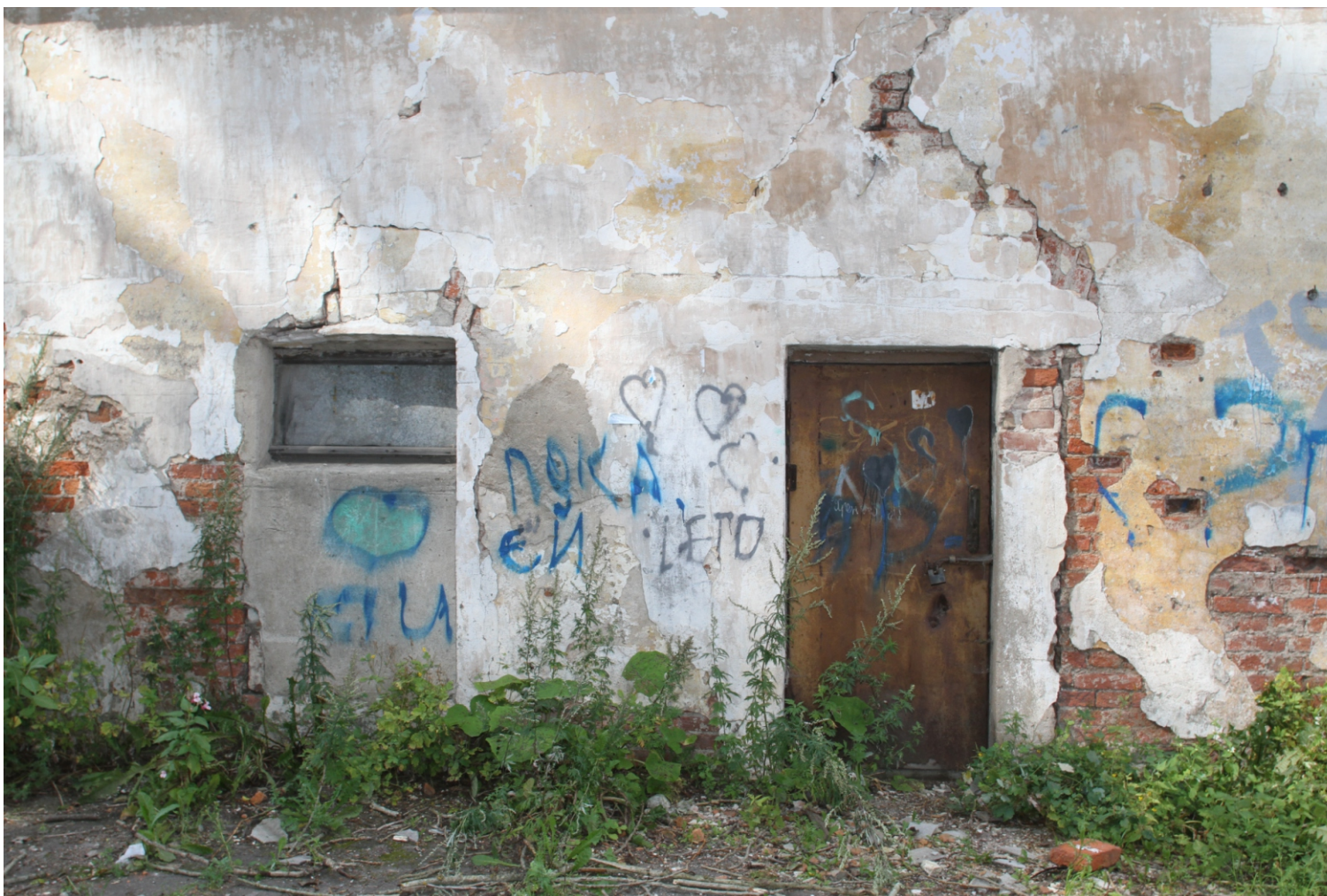
Ил. 19 «Жилой дом -бывший дом Г.Е.Ильинского, XVIII-XIX вв.», входящий в состав ансамбля «Комплекс жилых и хозяйственных зданий, XVIII-XIX вв.». Ленинградская обл., Волховский район, г. Новая Ладога, наб. Ладожской Флотилии, д.22. Хозяйственное здание. Восточный фасад. Фрагмент. Левая часть. Фото: 15.08.2017.
