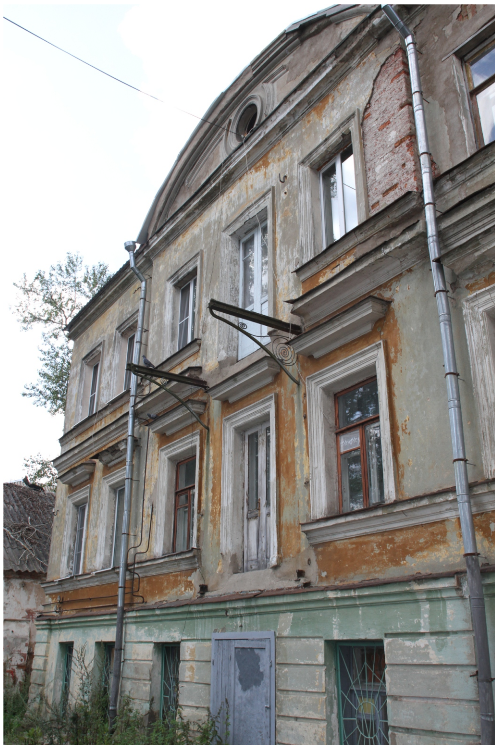
Ил. 4 «Жилой дом -бывший дом Г.Е.Ильинского, XVIII-XIX вв.», входящий в состав ансамбля «Комплекс жилых и хозяйственных зданий, XVIII-XIX вв.». Ленинградская обл., Волховский район, г. Новая Ладога, наб. Ладожской Флотилии, д.22. Жилой дом. Лицевой фасад. Фрагмент. Центральная часть. Фото: 15.08.2017.
