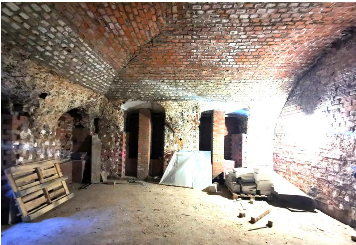
Фото 29. Строение 1. Центральная часть. Помещение правого крыла 1-го этажа. Фрагмент интерьера. Март 2022 г.
