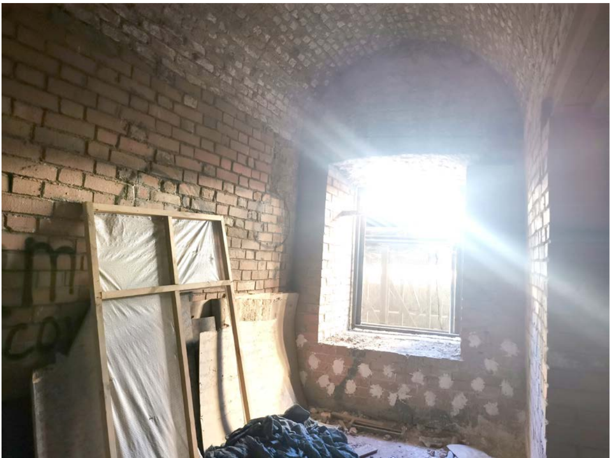
Фото 32. Строение 1. Центральная часть. Помещение правого крыла 1-го этажа. Фрагмент интерьера. Март 2022 г.
