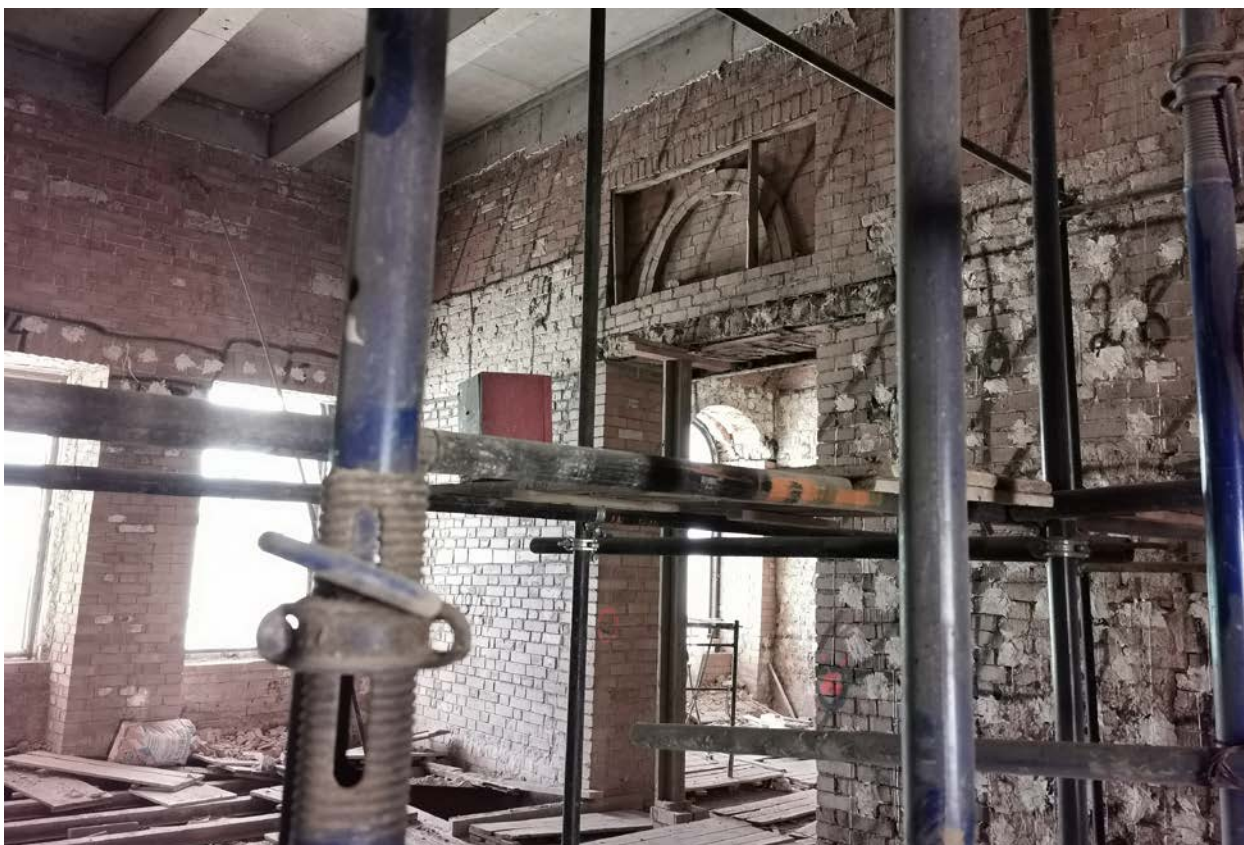
Фото 55. Строение 1. Центральная часть. Помещение 2-го этажа правого крыла. Фрагмент интерьера. Март 2022 г.
