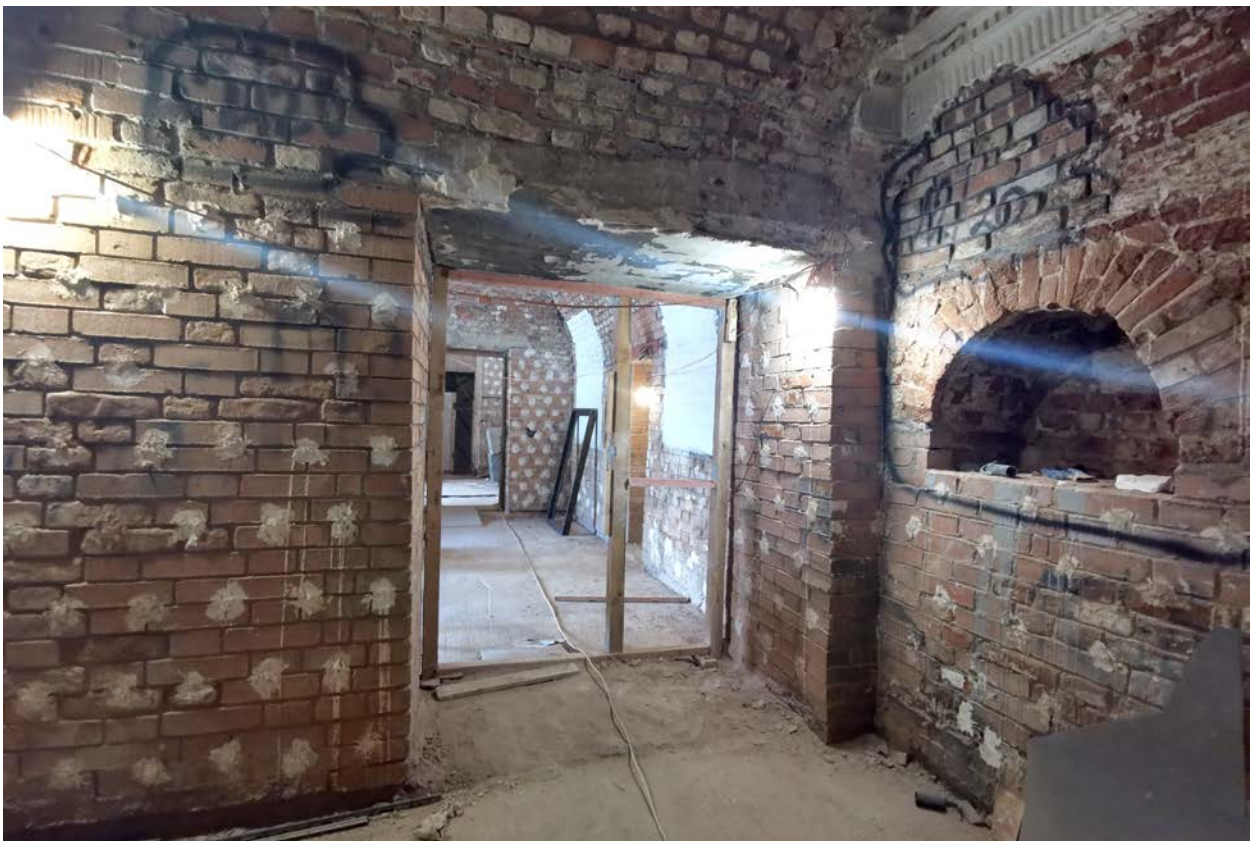
Фото 22. Строение 1. Центральная часть. Помещение правого крыла 1-го этажа. Фрагмент интерьера. Март 2022 г.
