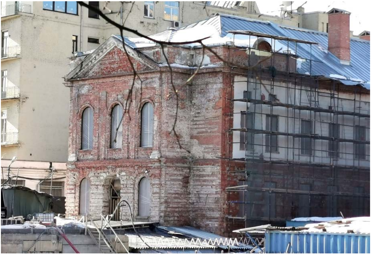
Фото 3. Строение 1. Левая пристройка. Вид с юго-востока со стороны Малого Знаменского пер. Март 2022 г.
